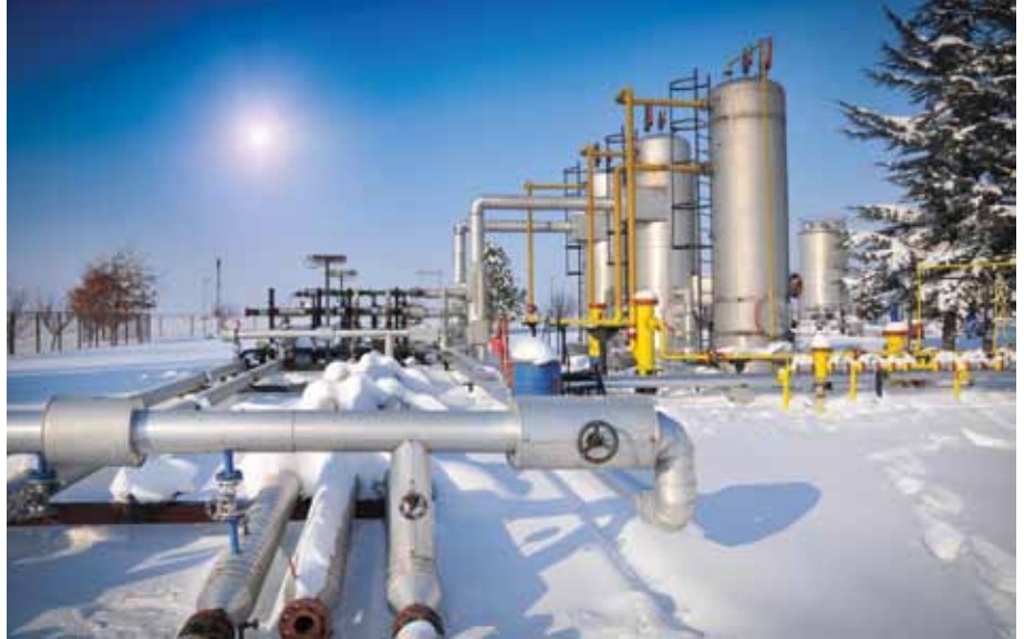
Figura 16. Planta de tratamiento de gas.
